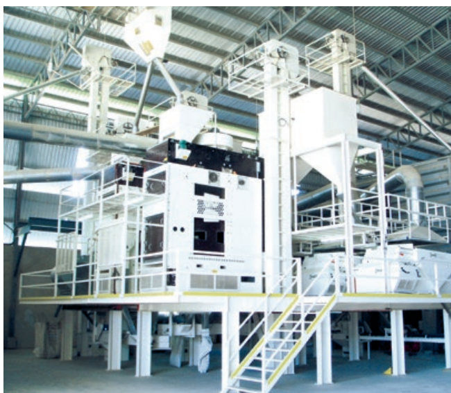
UBS montada sobre plataforma.
