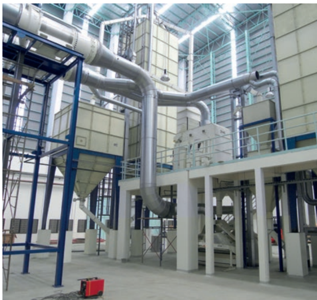
Detalhe do sistema de aspiração e controle de pó de uma UBS
